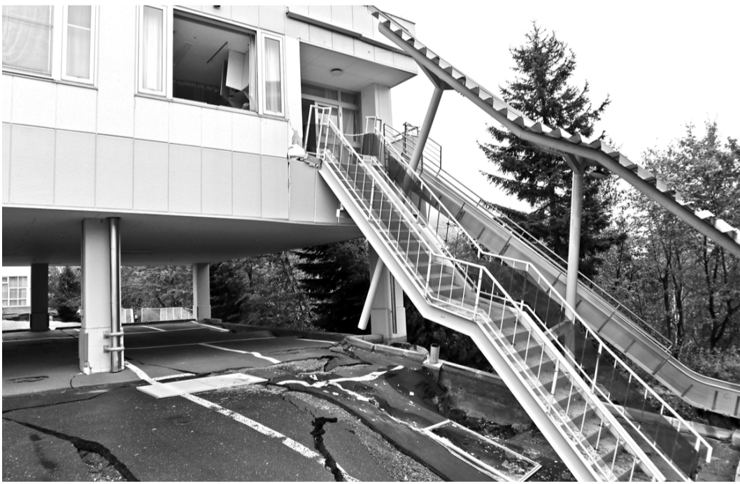
地面は陥没し、屋外階段が傾いた状態
